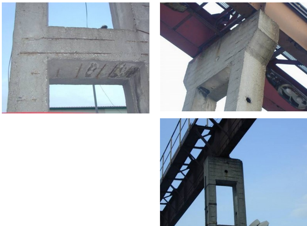
Obr. 4.65 Detaily sloupu, viditelná koroze výztuže odlupující se beton. Uložení jeřábové dráhy.
